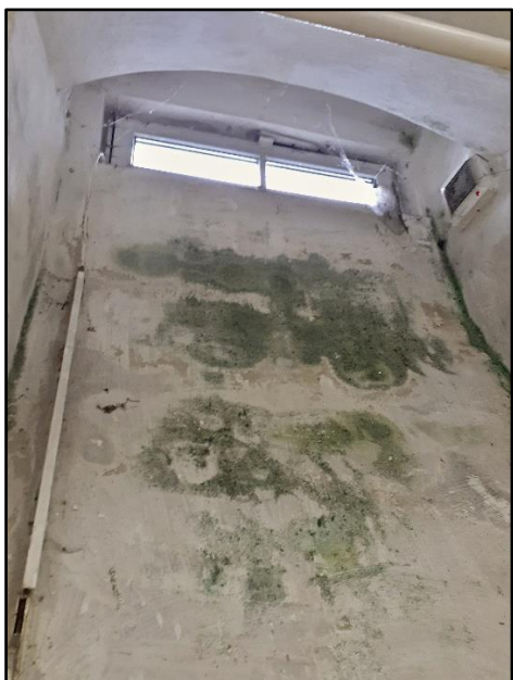
plíseň pod oknem suterénu
